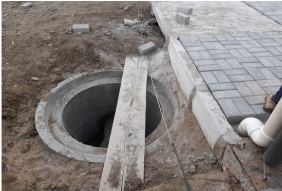
ITEM 2.4.3 (Poço de Visita)
