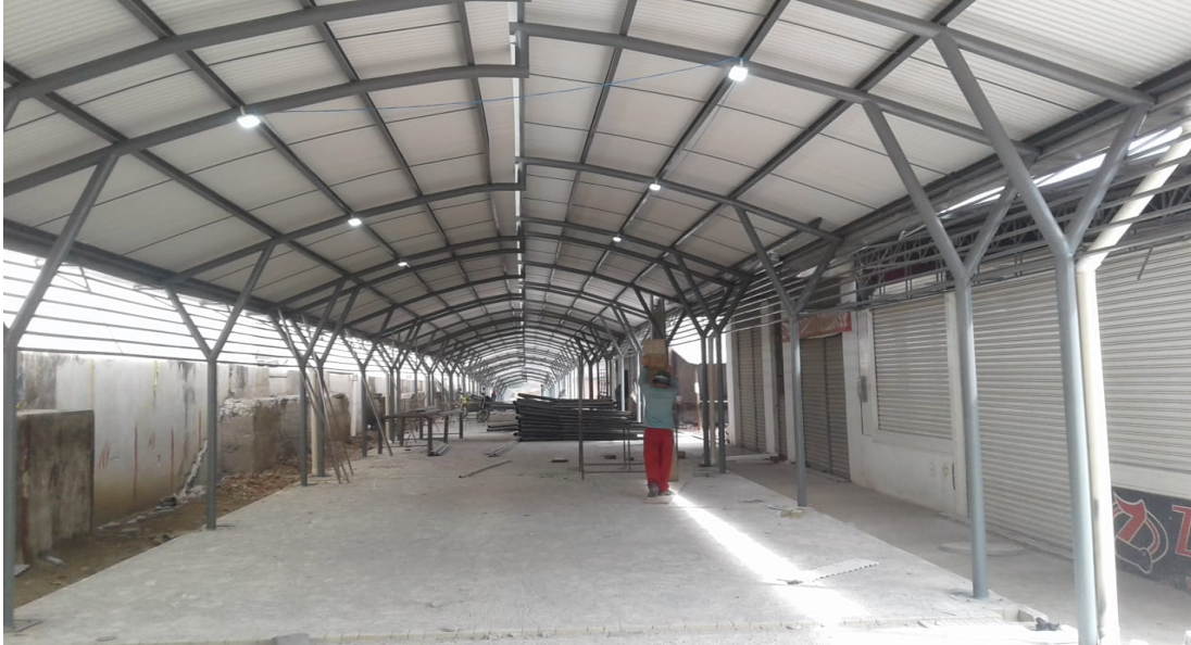
Foto 07 (Instalação Elétrica ITEM 6.1 e SUBITENS)
