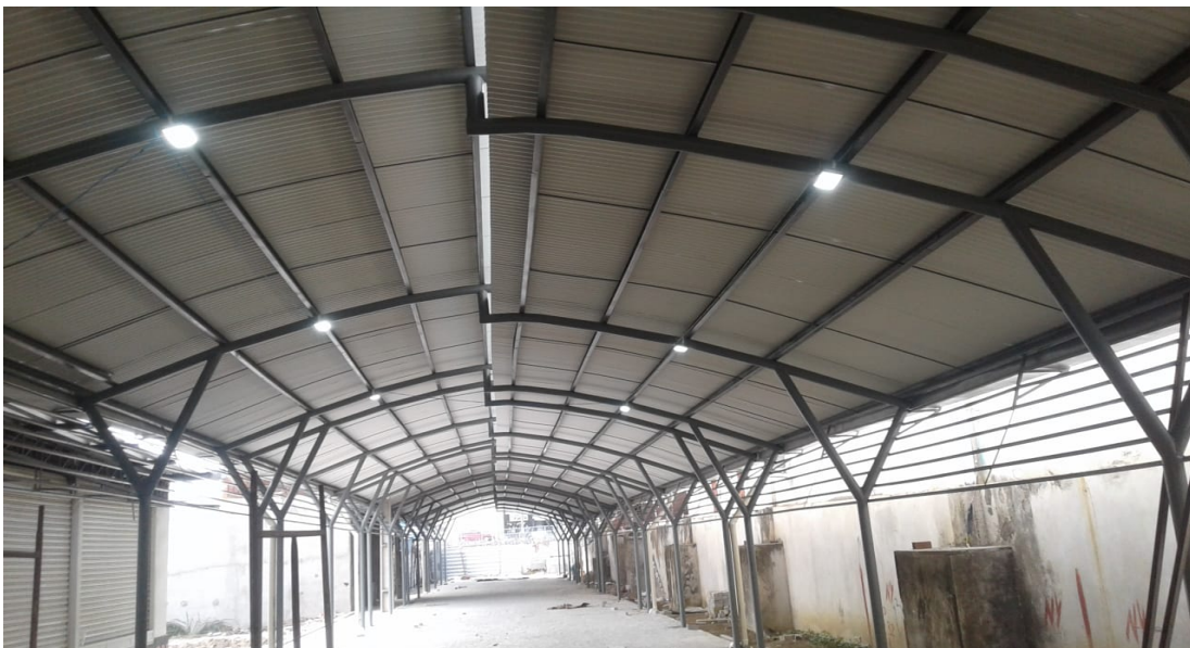
Foto 08 (Instalação Elétrica ITEM 6.1 e SUBITENS))
