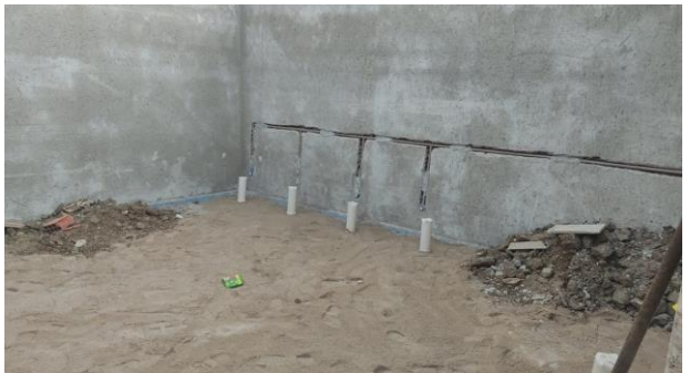
FOTO - 38 Alojamento - Inst. Hidráulica e Sanitária
