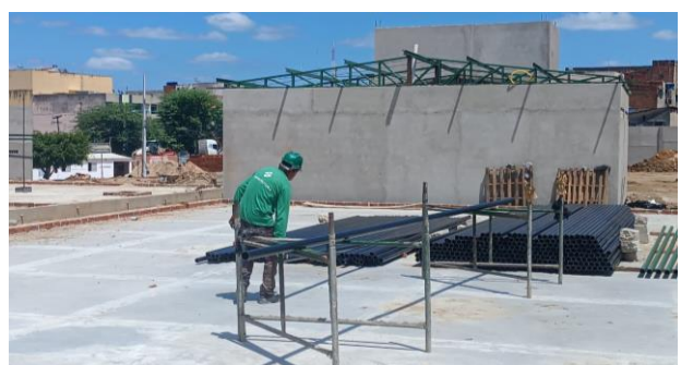
FOTO - 24 Banheiro de Esportes - Revestimentos e estrutura de cobertura
