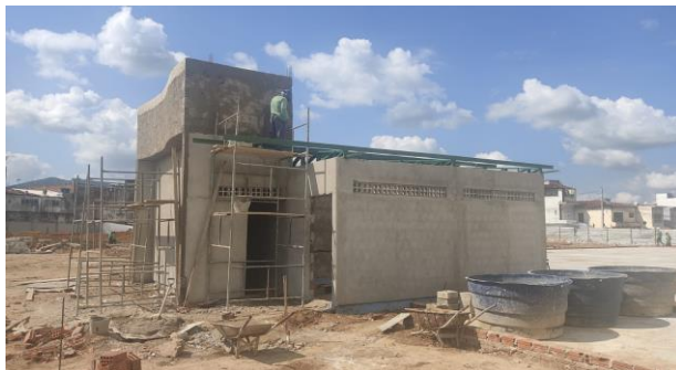
FOTO - 23 Banheiro de Esportes - Revestimentos e estrutura de cobertura
