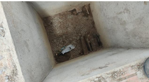
FOTO -5 Eletrodutos para instalações elétrica geral
