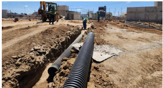
FOTO -4 Rede de águas pluvias
