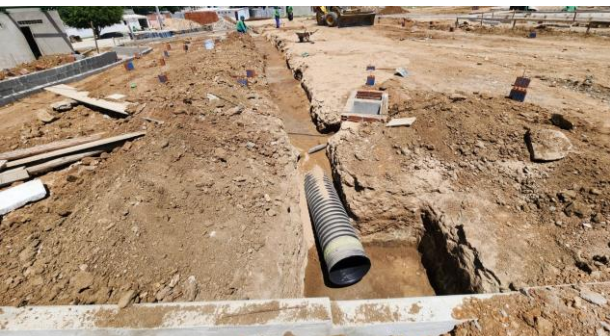
FOTO -5 Rede de águas pluvias
