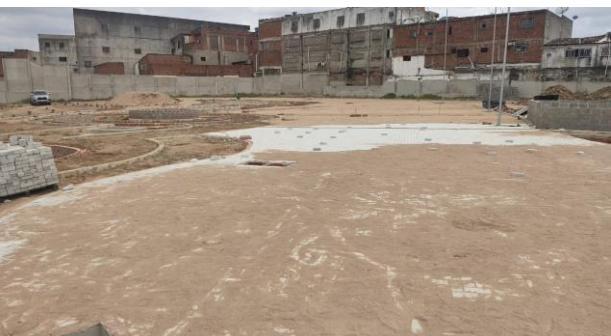
FOTO - 19 Piso em intertravado e postes de 9m (área de eventos e espelhos d' água)
