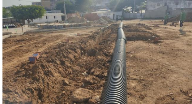
FOTO -2 Rede de águas pluvias
