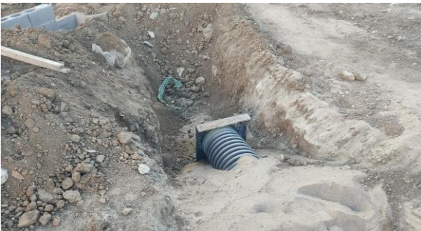
FOTO -3 Rede de águas pluvias
