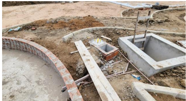
FOTO - 22 Instalações hidráulica (área de eventos e espelhos d' água)
