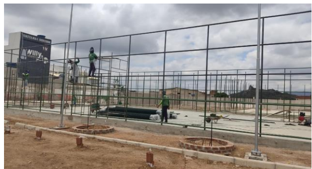
FOTO -6 Poste cônico de 9m
