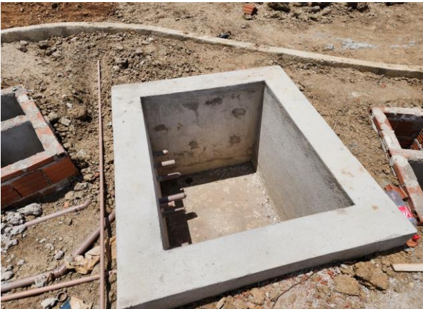
FOTO - 23 Instalações hidráulica (área de eventos e espelhos d' água)
