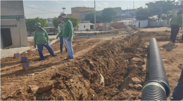
FOTO -1 Rede de águas pluvias
