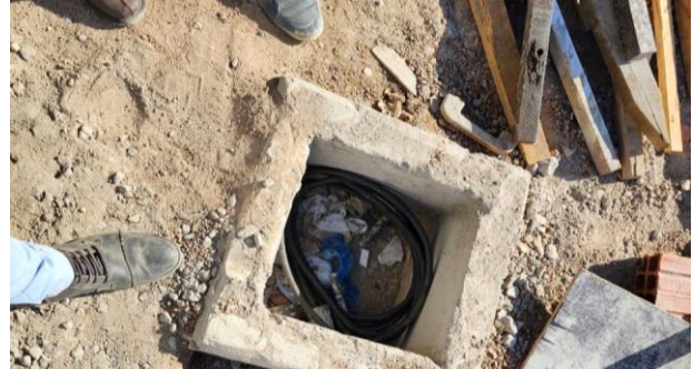
FOTO -2 Cabos da rede elétrica da área de eventos e espelhos d'água
