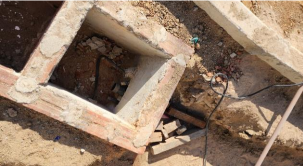
FOTO -1 Cabos da rede elétrica da área de eventos e espelhos d'água
