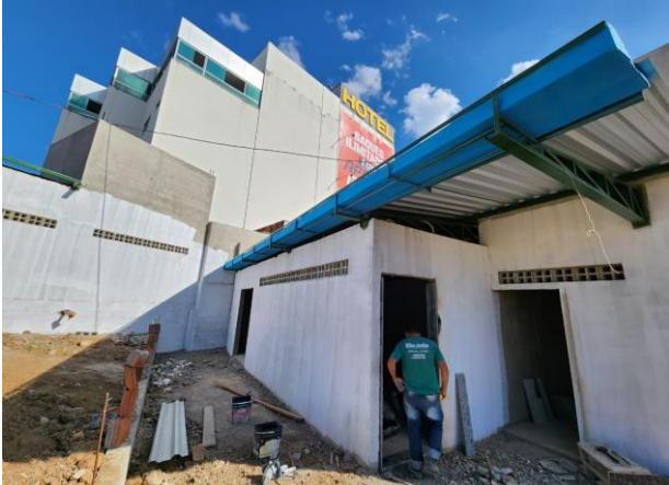
FOTO - 25 Banheiro de Piquenique (calhas)
