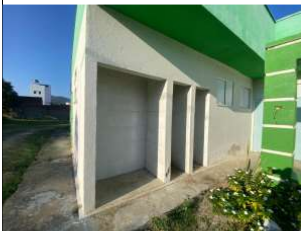
Figura 7 PORTÃO FOI DANIFICADO E REMOVIDO NECESSÁRIO SUBSTITUIÇÃO.
