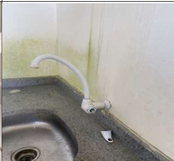
Figura 4 NECESSÁRIO TROCA DE TORNEIRA.
