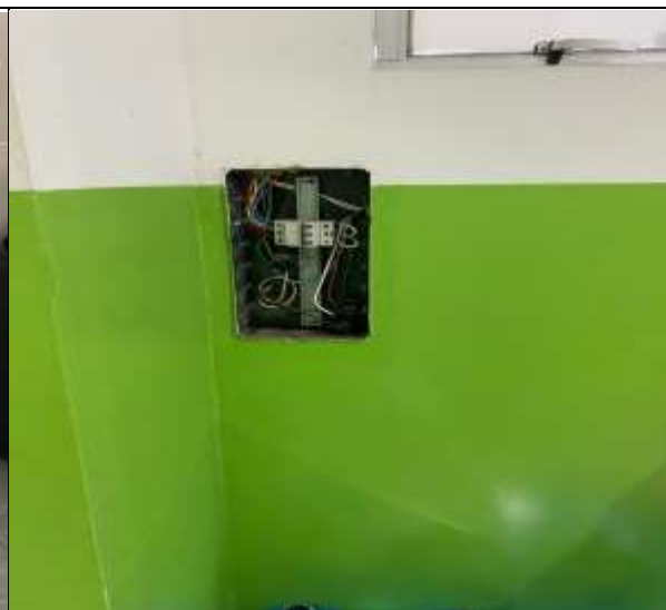
Figura 6 NECESSÁRIO COLOCAR CAIXA DE DISTRIBUIÇÃO.
