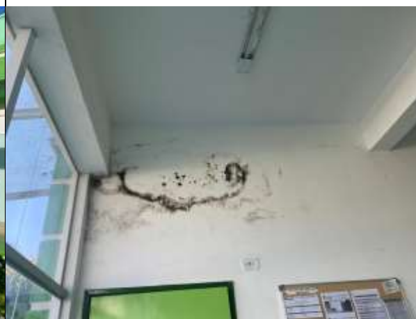
Figura 8 NECESSÁRIO REPARO PAREDE COM INFILTRAÇÃO.
