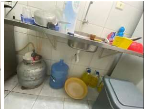
Figura 6 NECESSÁRIO REPARO NO SIFÃO.
