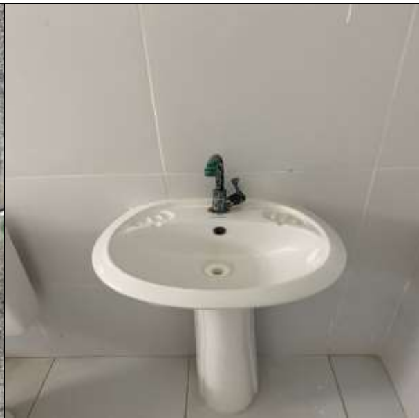
Figura 2 NECESSÁRIO TROCA DA TORNEIRA.
