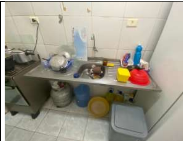
Figura 5 NECESSÁRIO REPARO NO SIFÃO.
