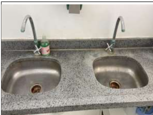
Figura 5 NECESSÁRIO SUBSTITUIÇÃO NA VÁLVULA.
