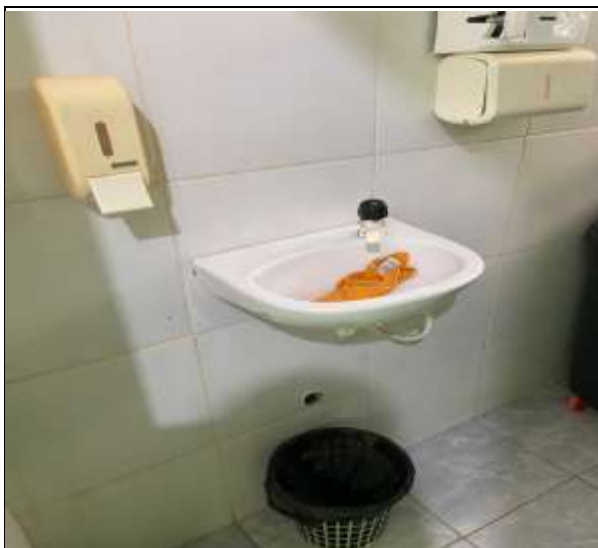
Figura 5 NECESSÁRIO REPARO NO SIFÃO.
